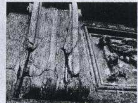
Freiliegende Eisenstäbe: Das Metall ist gerostet und hat das Mauerwerk wie hier gesprengt.
