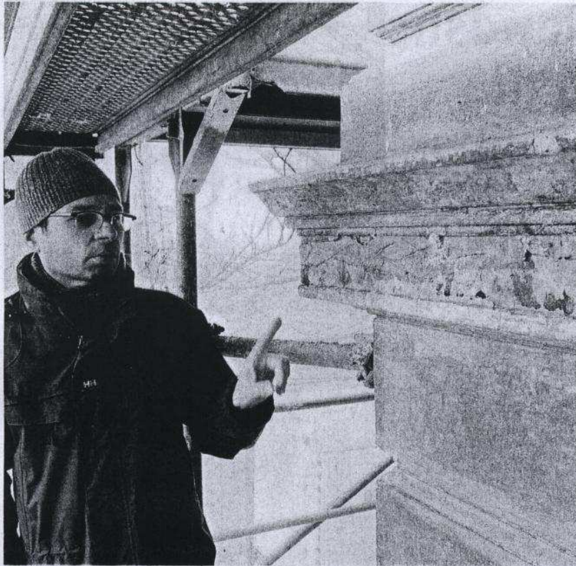
Aus der Nähe betrachtet, ringt die Maurerkunst früherer Jahre Ståwog-Architekt Rüdiger Arndt immer noch große Bewunderung ab. Jede Fuge ist total akkurat gearbeitet. Doch der Zahn der Zeit hat dem über 100 Jahre alten Gebäude erheblich zugesetzt. Deswegen muss es jetzt aufwendig grundsaniert werden. Fotos eer
