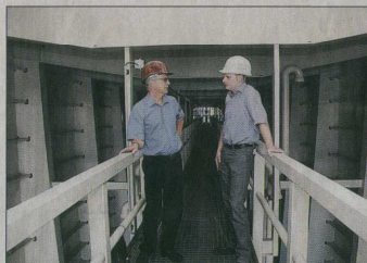
Hans-Werner Vollstedt (links) und Stefan Jann im Wartungsgang eines Schleusentors der Kaiserschleuse, der bei Hochwasser komplett unter Wasser stehen wird.
